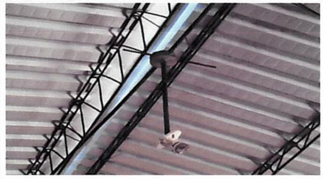
Foto 2: Necesidad de lámparas led y sistema electrico
